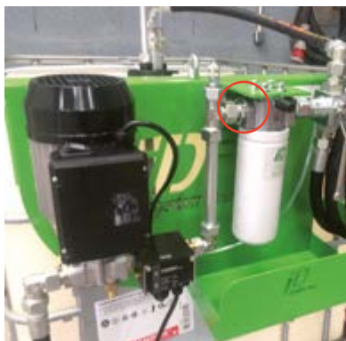
Indicateur de colmatage, bac de rétention
